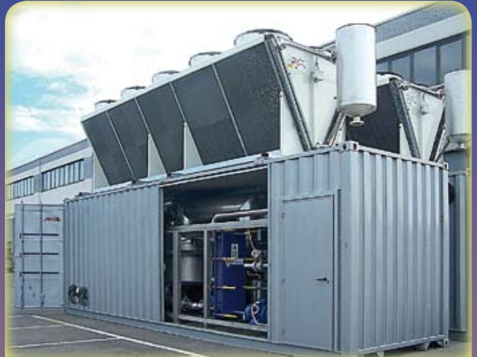
Figura 4 - Unità mobile di evaporazione - interno.
