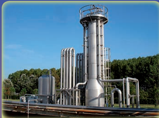
Impianto di ozonolisi dei fanghi di supero.
