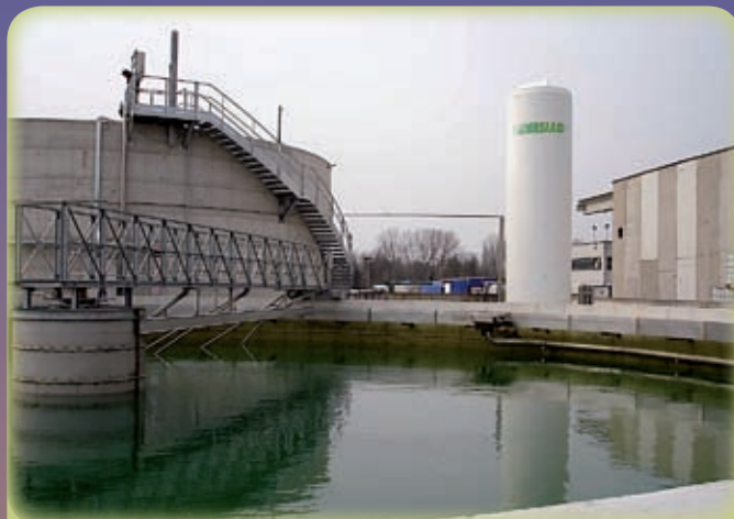
impianto di depurazione.
